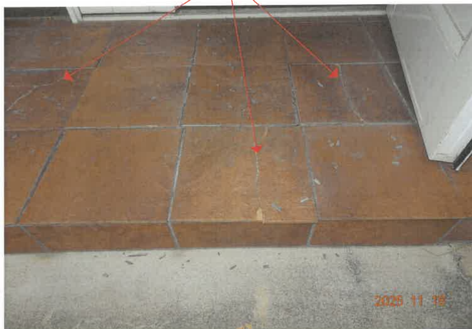
⑦ (玄関タイル 損傷箇所)
