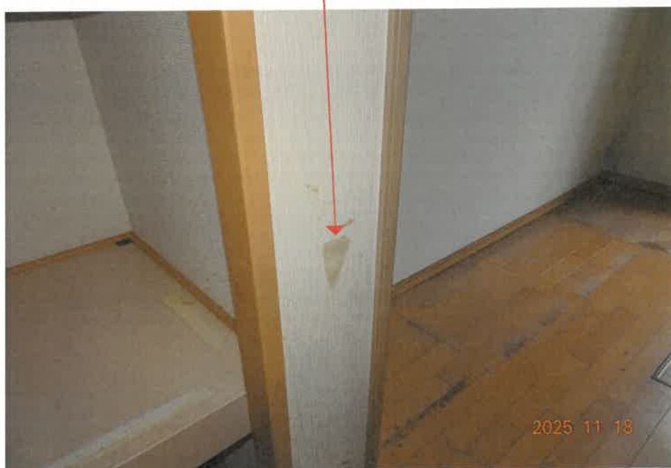
⑧ (1階リビングダイニング クロス剥離箇所)
