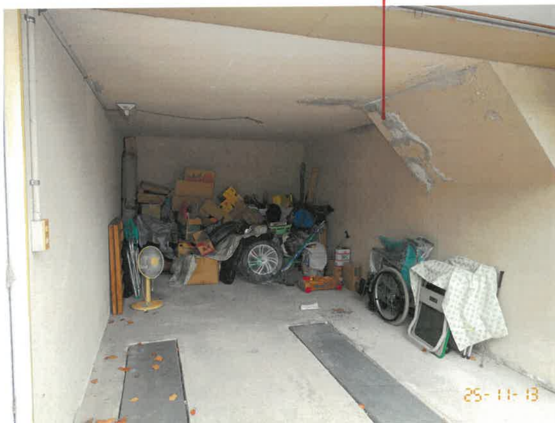
モルタルの剥がれ
