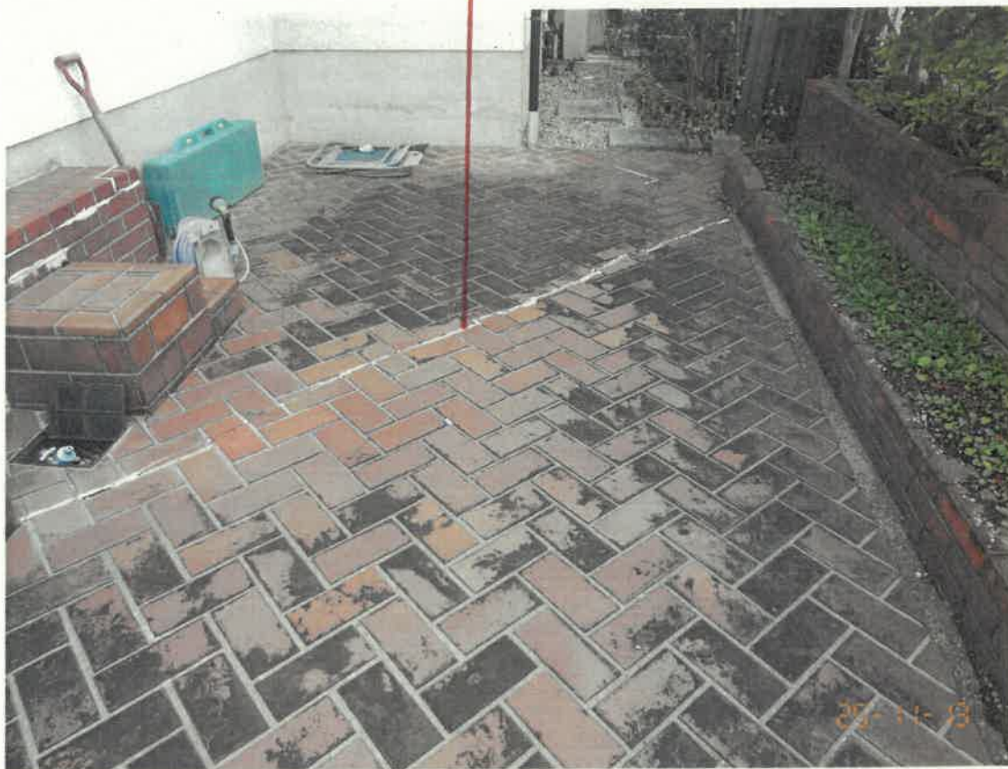
玄関付近の地面にひび割れあり
