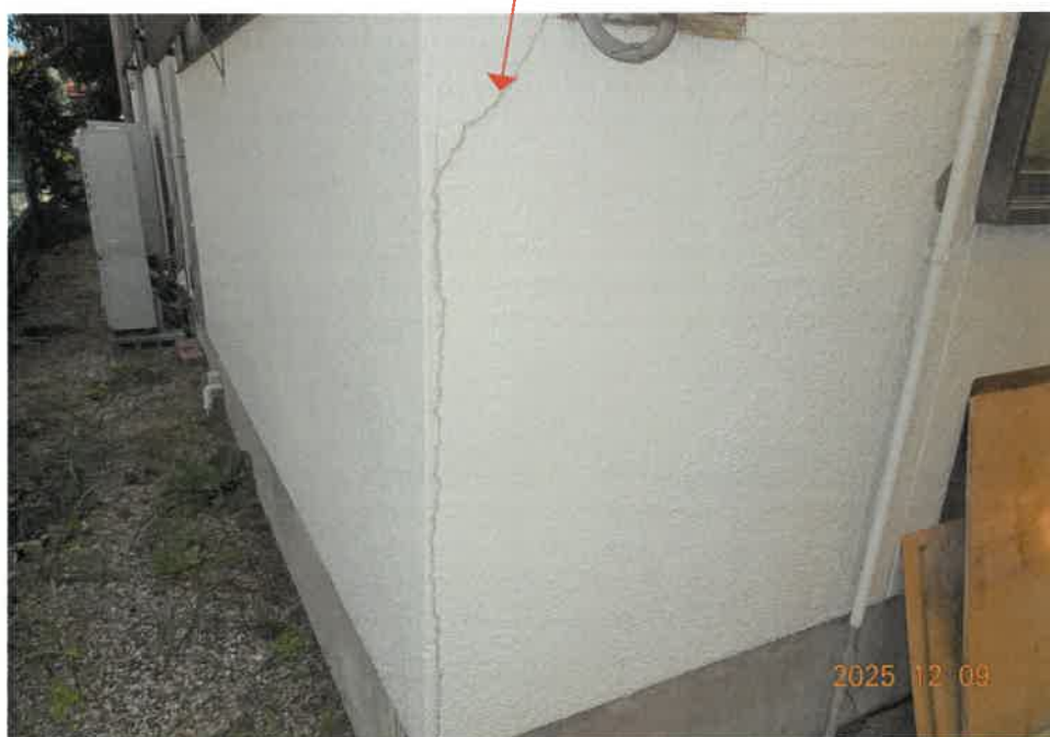
⑩ (外壁クラック)
