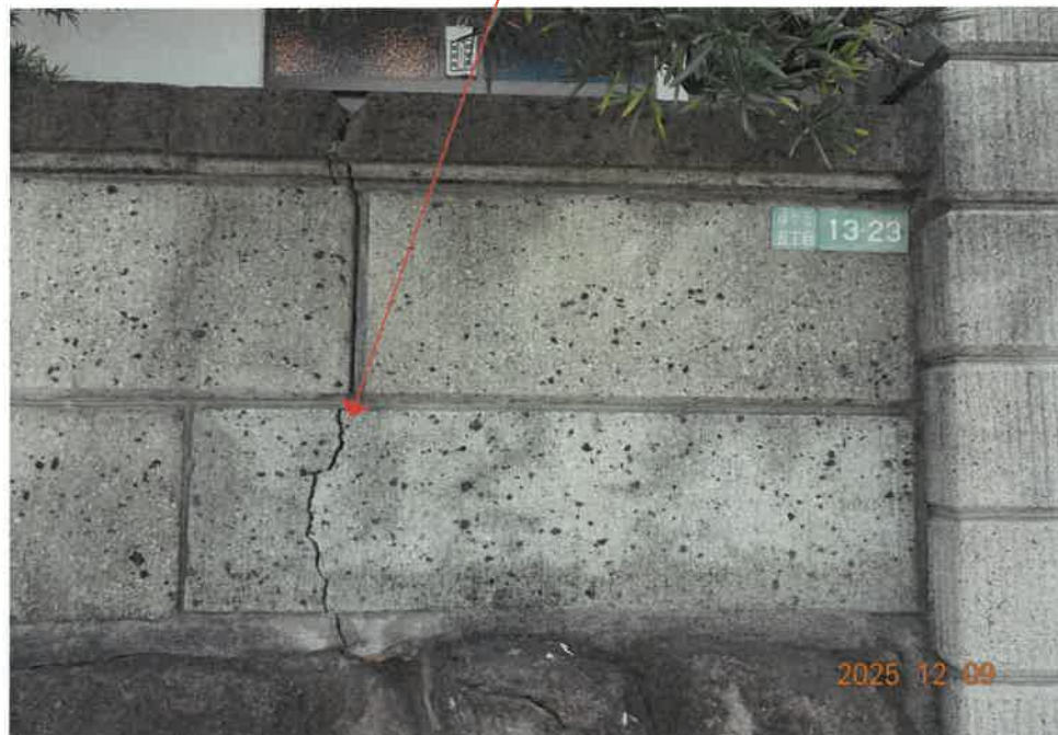
⑨ (コンクリート塀クラック)
