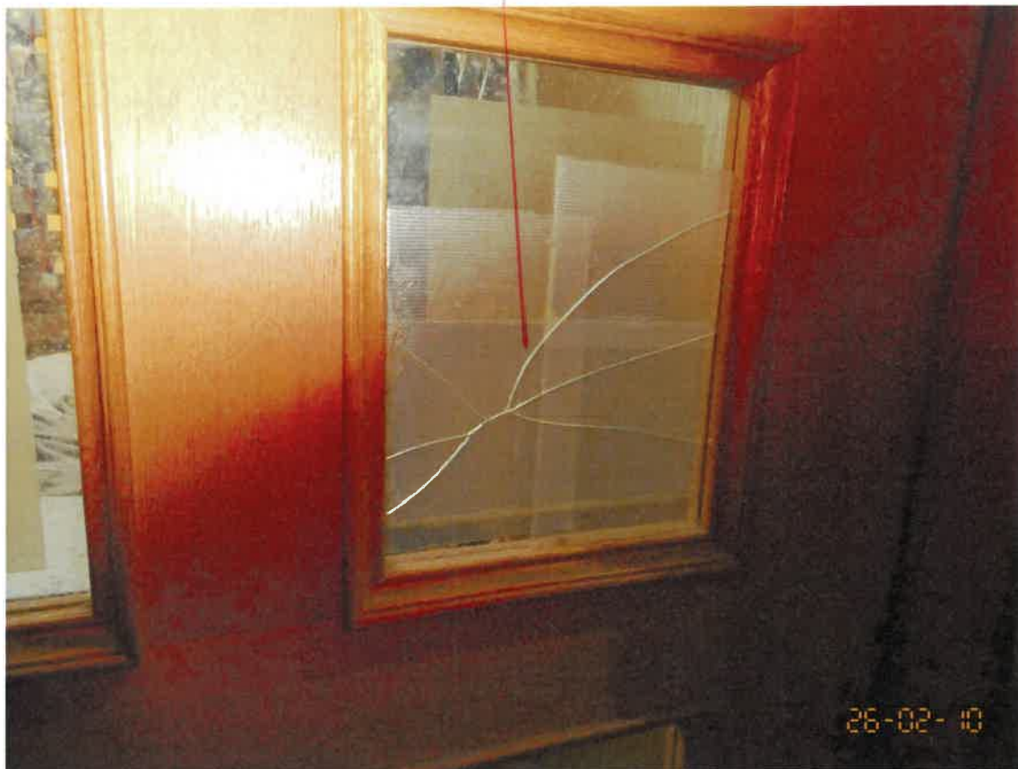
ガラスの破損
