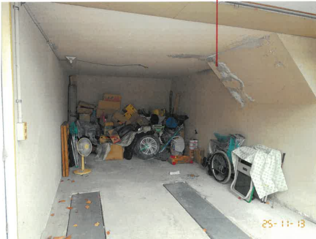
モルタルの剥がれ
