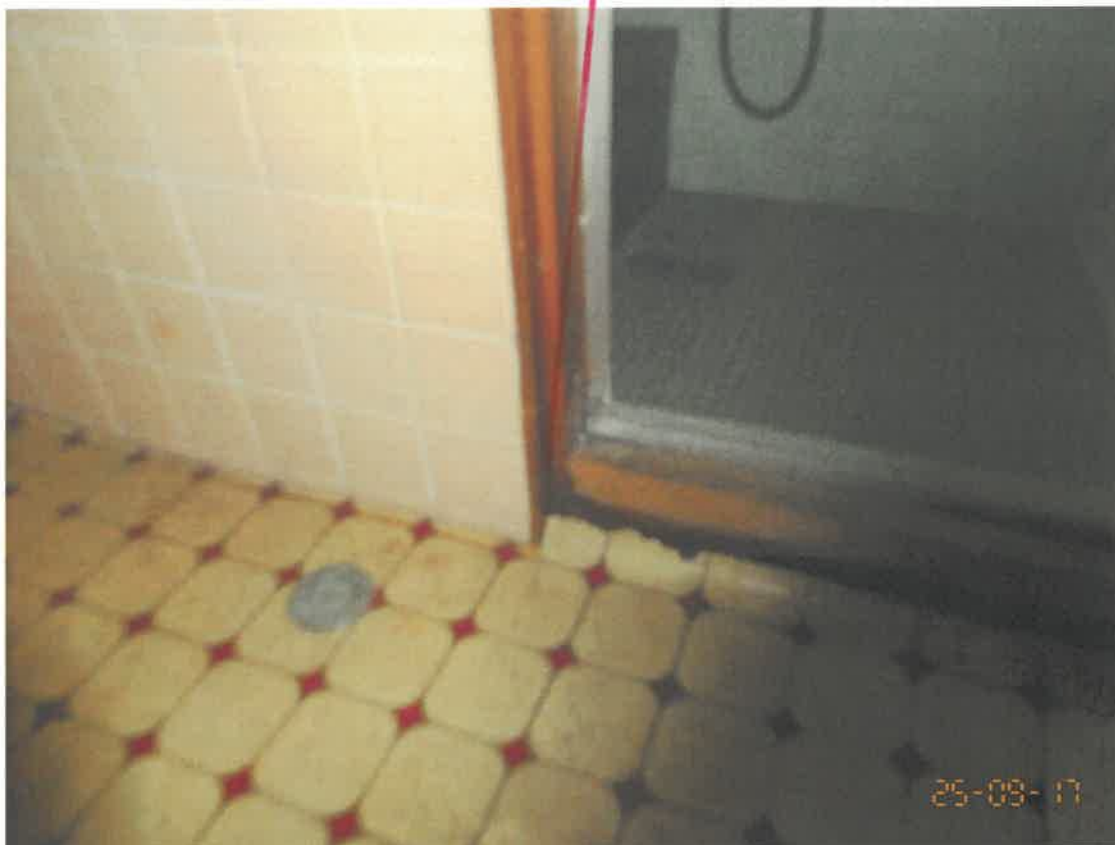
白蟻によると思われる腐食
