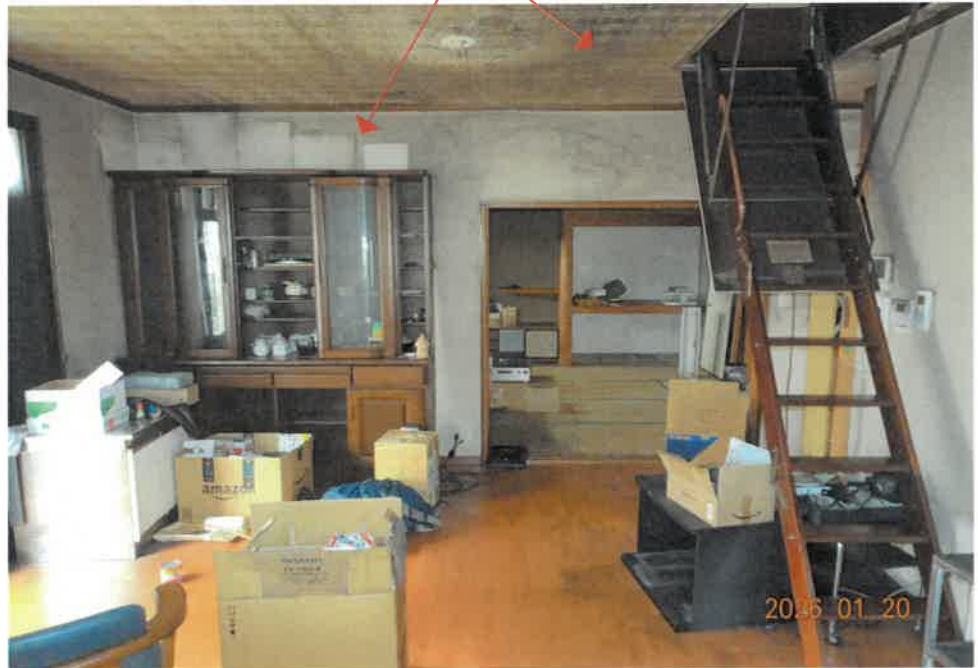
③ (壁及び天井の黒ずみ)
