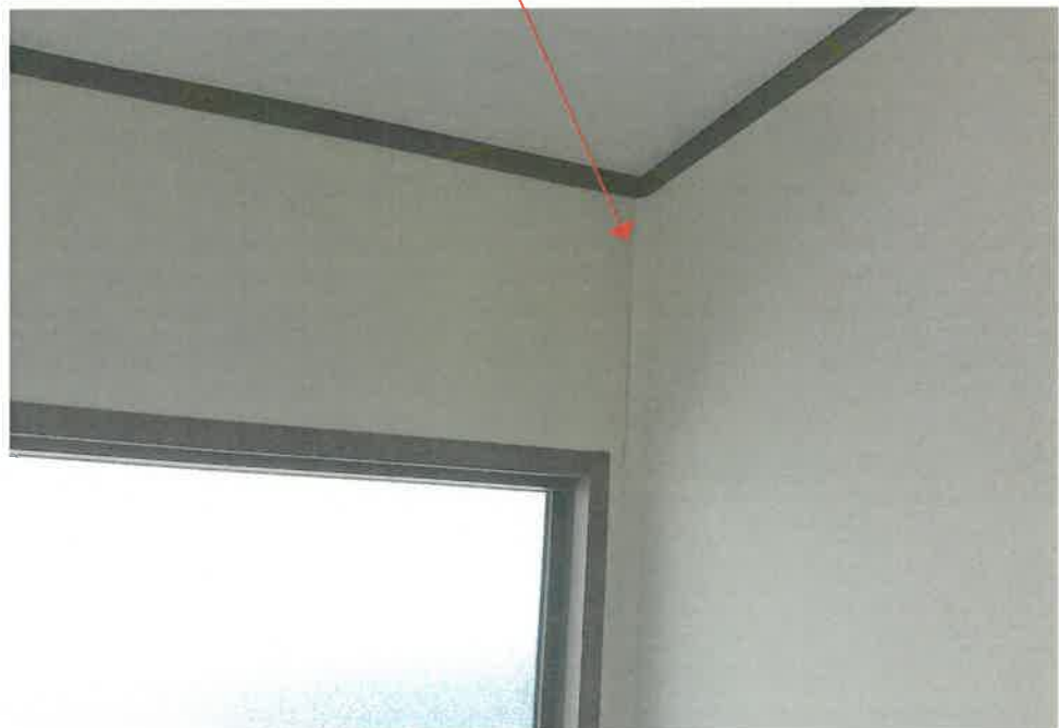
⑧ (2階階段の壁 クラック)
