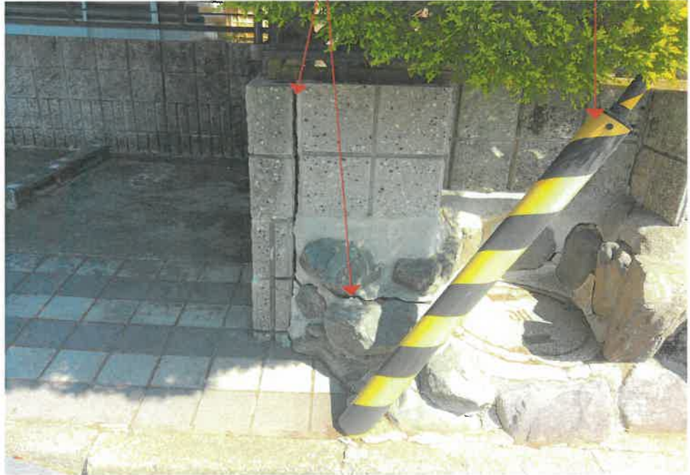
⑦ (コンクリートブロックひび割れ箇所) (電柱支線)
