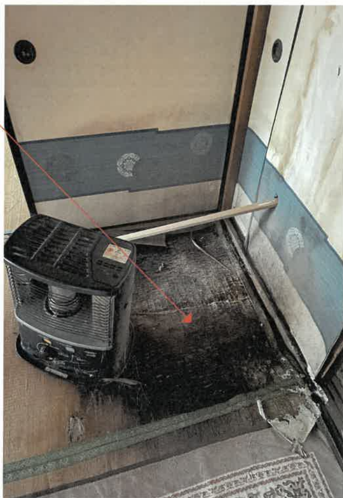
⑭ (附属建物 畳 損傷箇所)
