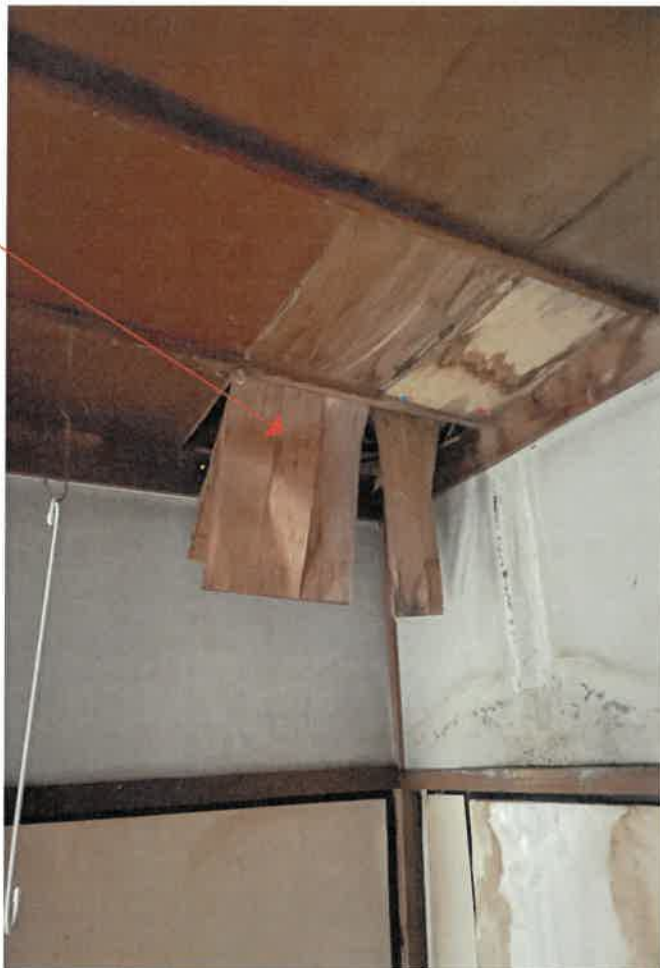
⑬ (附属建物 天井 破損箇所)
