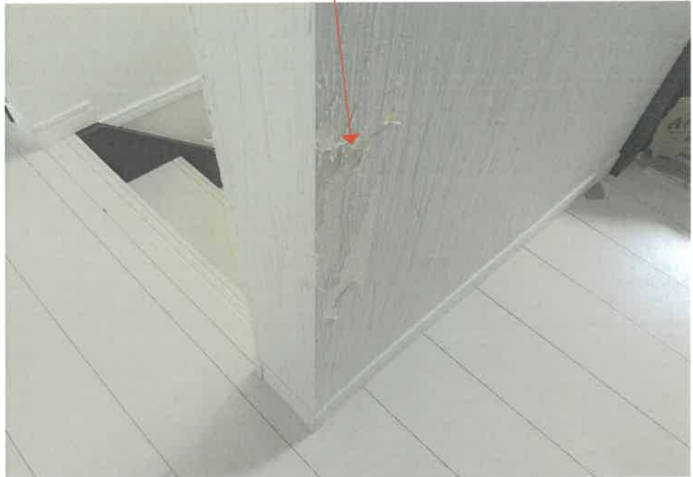
⑦ (2階ホール 壁損傷箇所)
