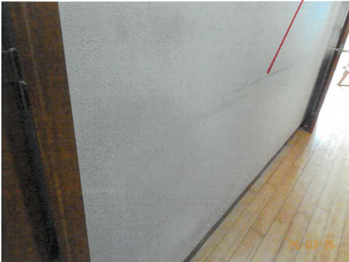
写真では分かりにくいですが猫の引っ掻き傷跡及び壁の汚れの状況
