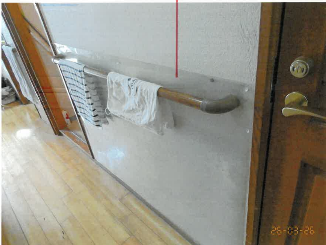
猫の引っ掻き傷跡を隠すためのパネル
