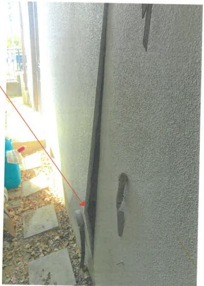
②⑩ (外壁剥離箇所)
