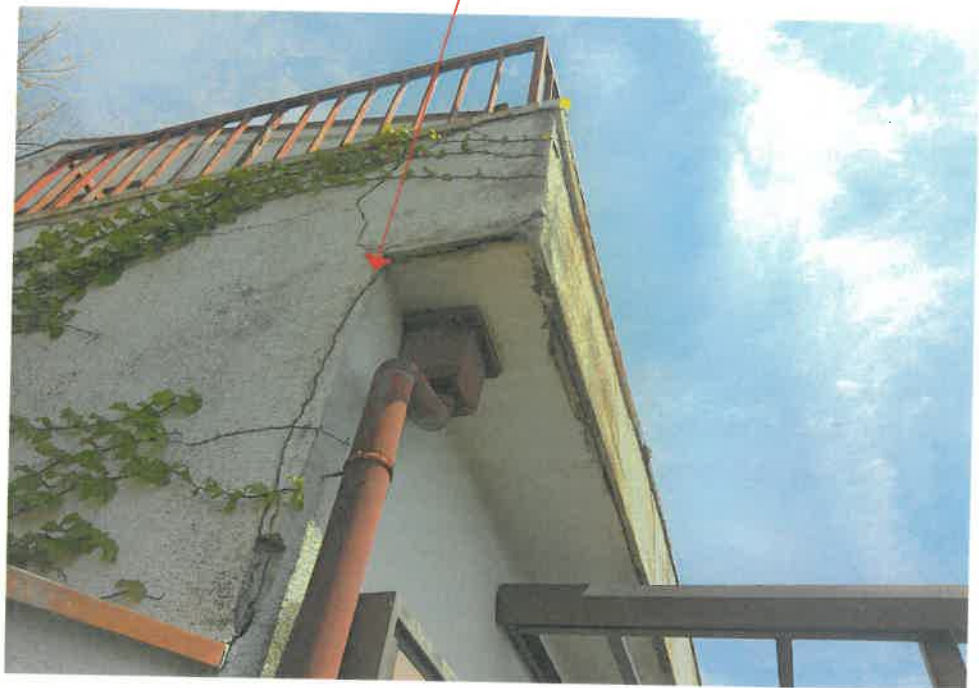
①⑨ (外壁 クラック)
