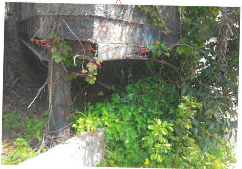
⑫ (鉄骨基礎 腐食部分)
