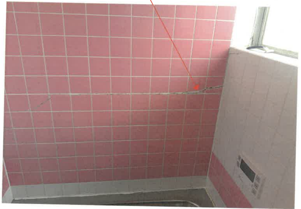
⑨ (浴室タイル クラック)
