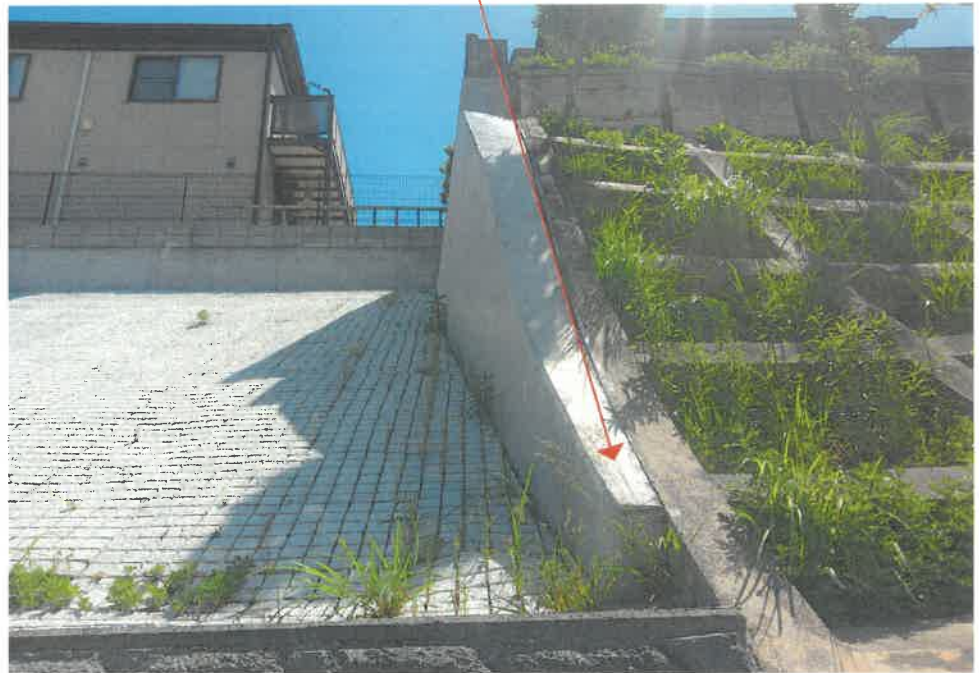
③ (越境している可能性がある北側隣接土地の法面)
