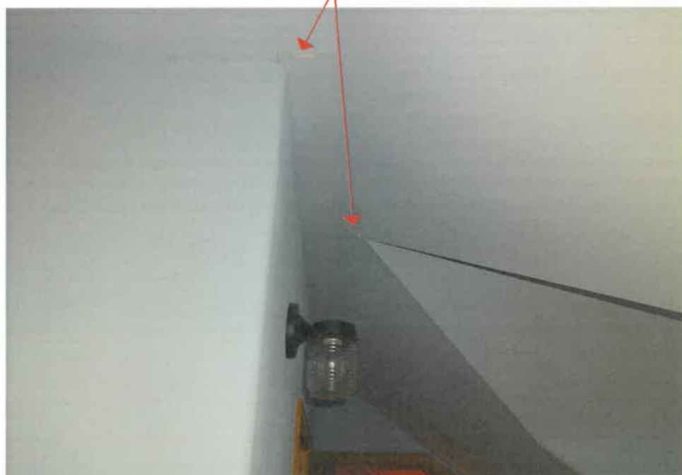
⑩ (2階南側洋室 壁クラック)
