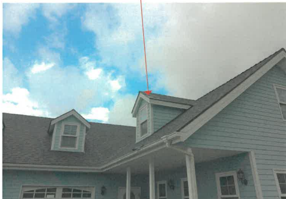
⑨ (ルーフィング剥離箇所)
