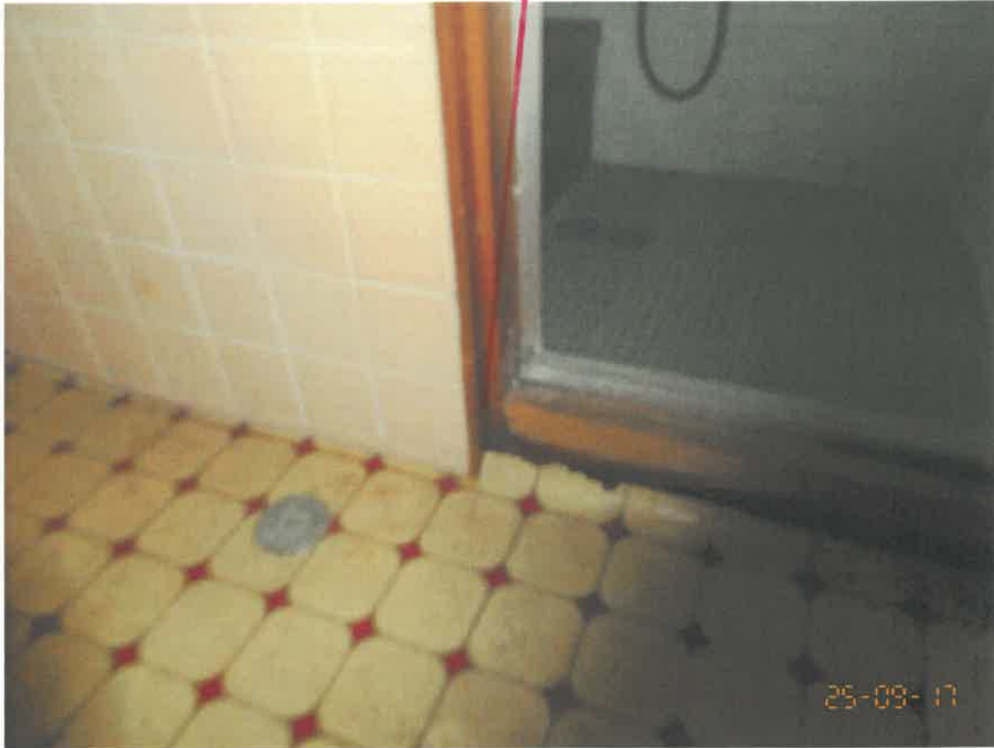
白蟻によると思われる腐食
