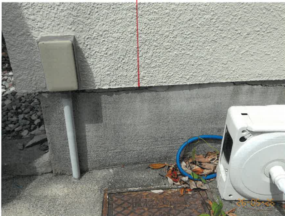
広範囲にひび割れ
