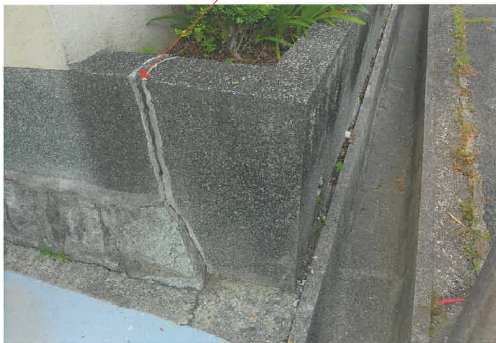
⑨ (外構 クラック)
