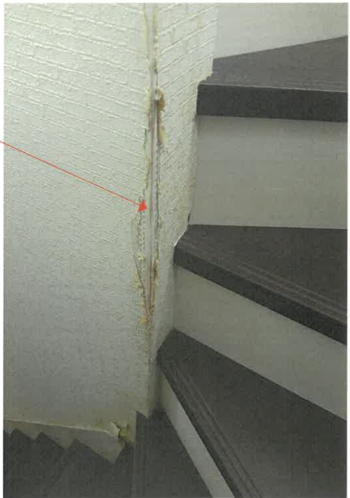
(階段 ⑨ クロス損傷箇所)
