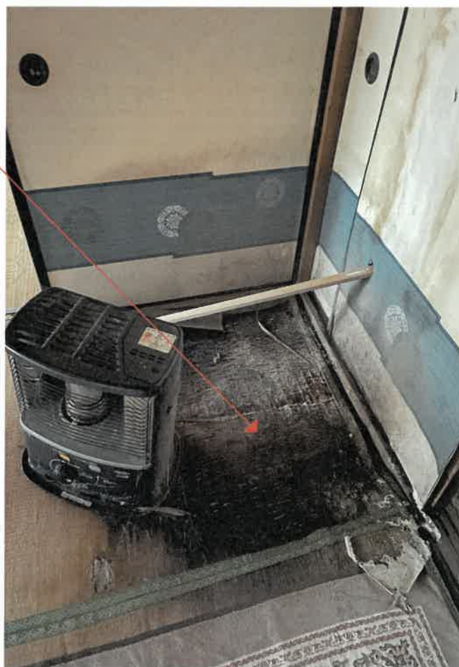
⑭ (附属建物 畳 損傷箇所)
