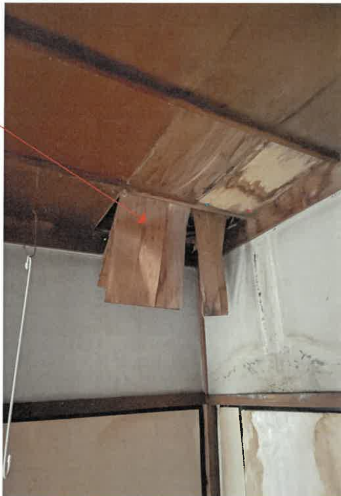
⑬ (附属建物 天井 破損箇所)
