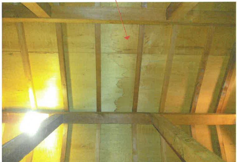
⑧ (屋根裏収納庫 天井のシミ)
