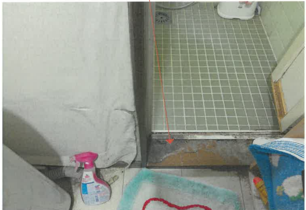
⑦ (1階浴室 腐食による損傷箇所)
