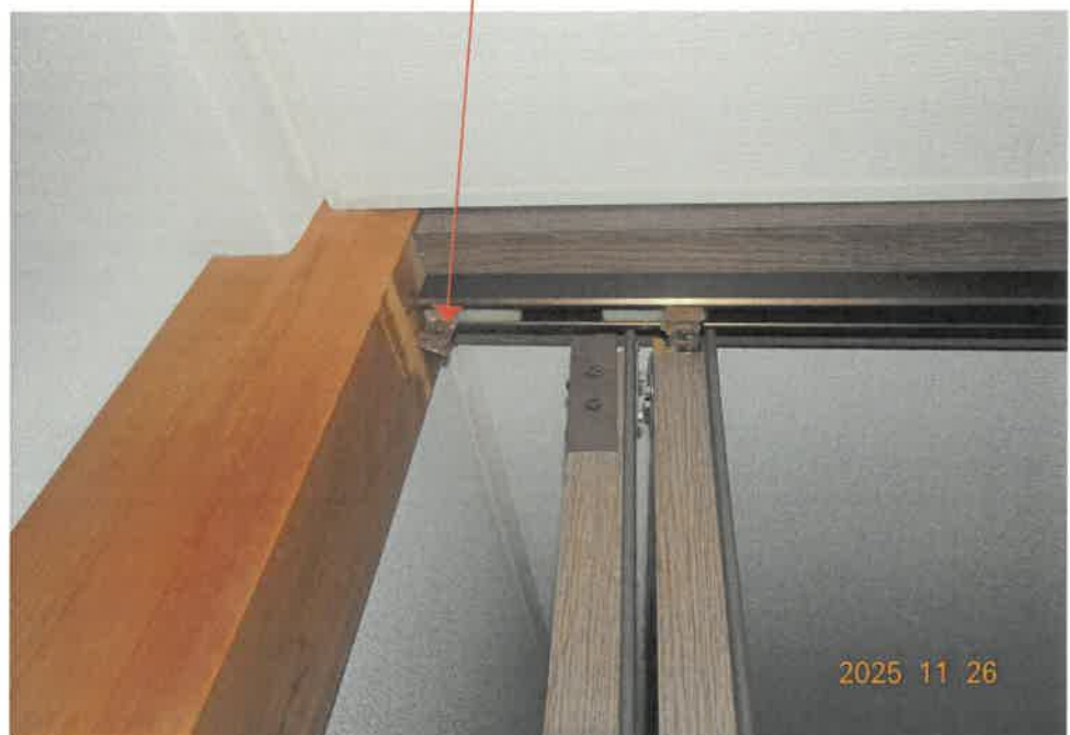
⑧ (アコーディオン式間仕切 金具損傷箇所)
