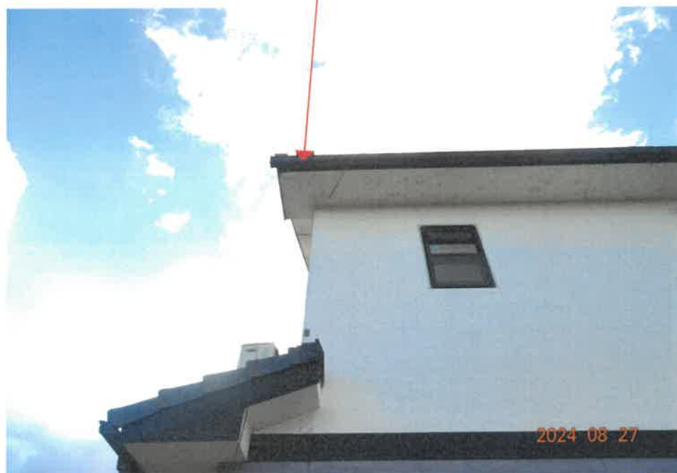
⑨ (雨樋欠落箇所)
