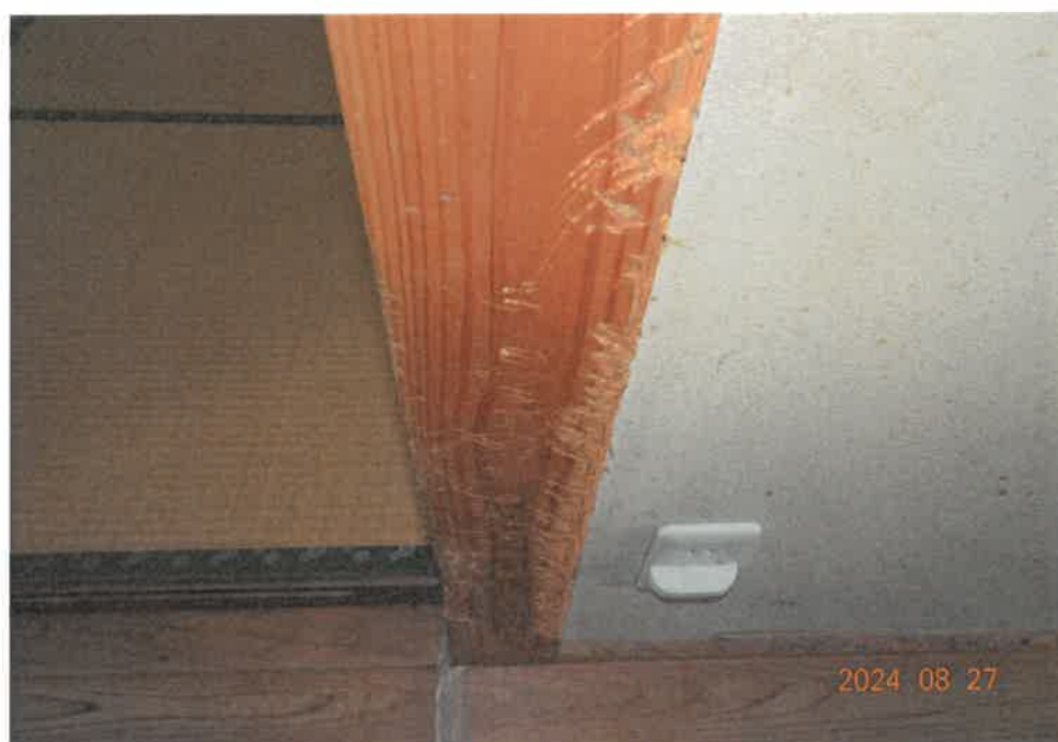
⑩ (1階廊下 犬の引っ掻き傷)
