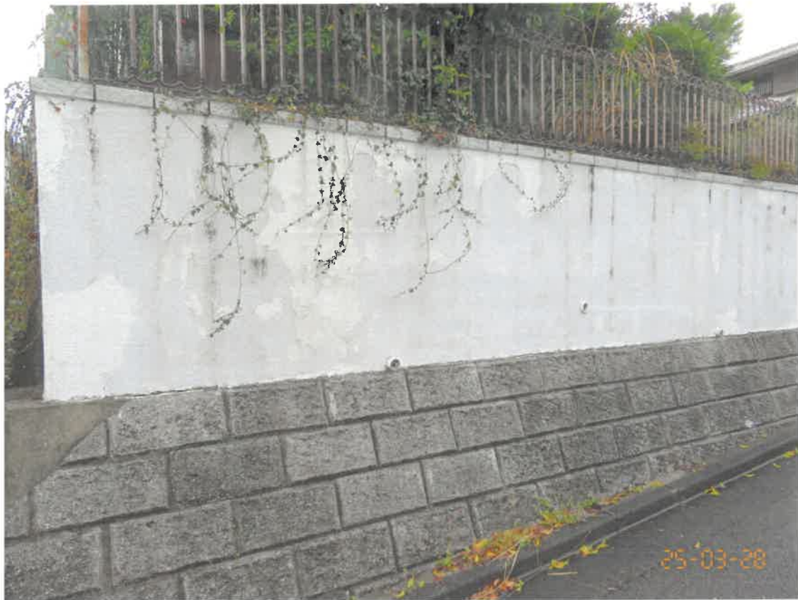
擁壁にモルタルの剥がれ
