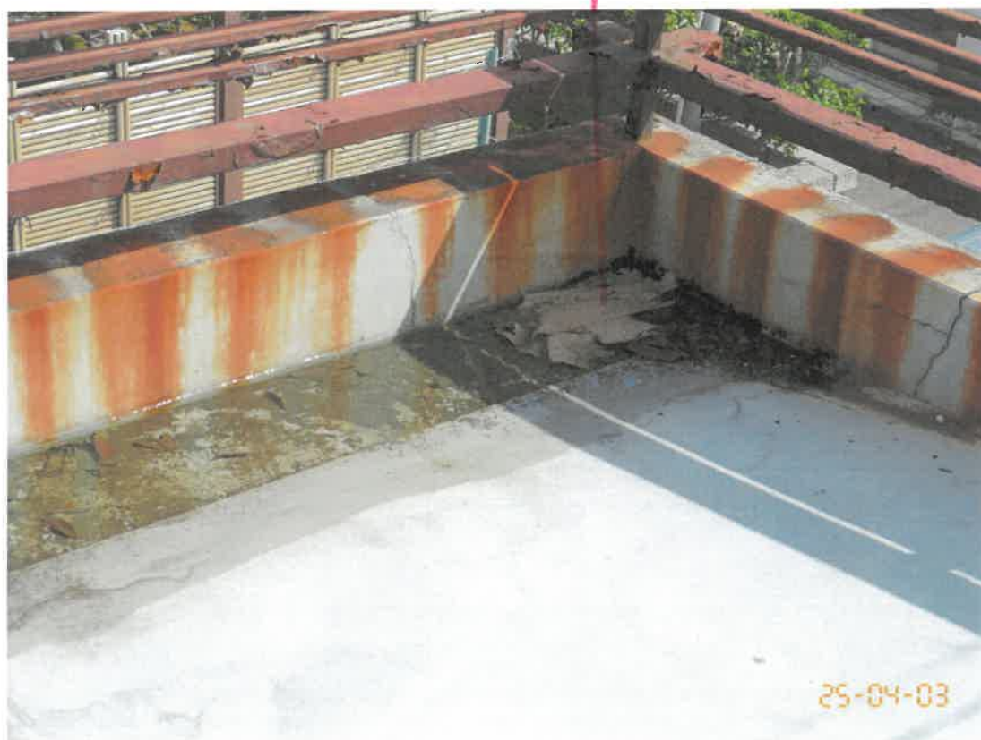
樋が詰まって、水が流れていない
