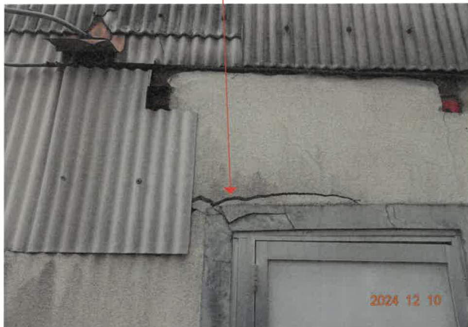
⑪ (外壁クラック)
