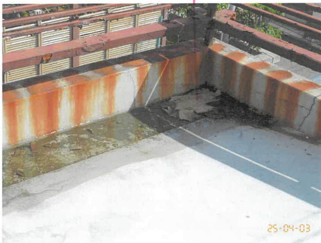
樋が詰まって、水が流れていない
