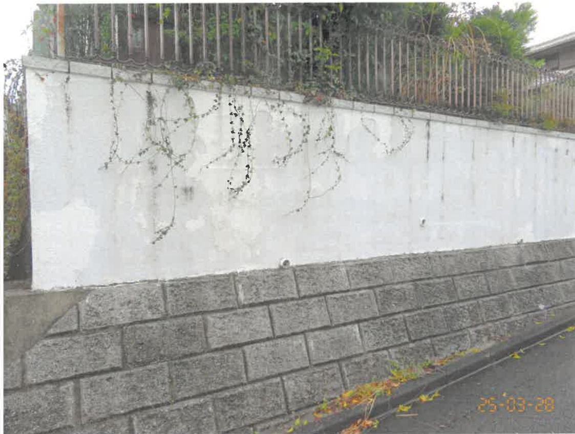
擁壁にモルタルの剥がれ
