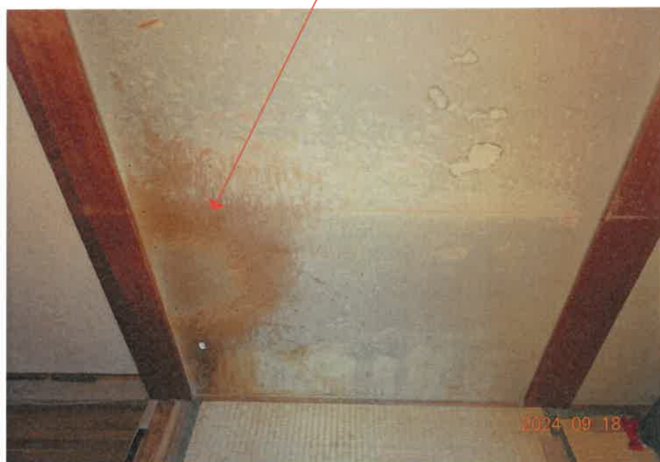
⑩ (2階南側和室 内壁汚損箇所)
