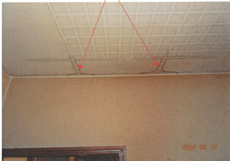
⑨ (DK天井 雨漏り跡)
