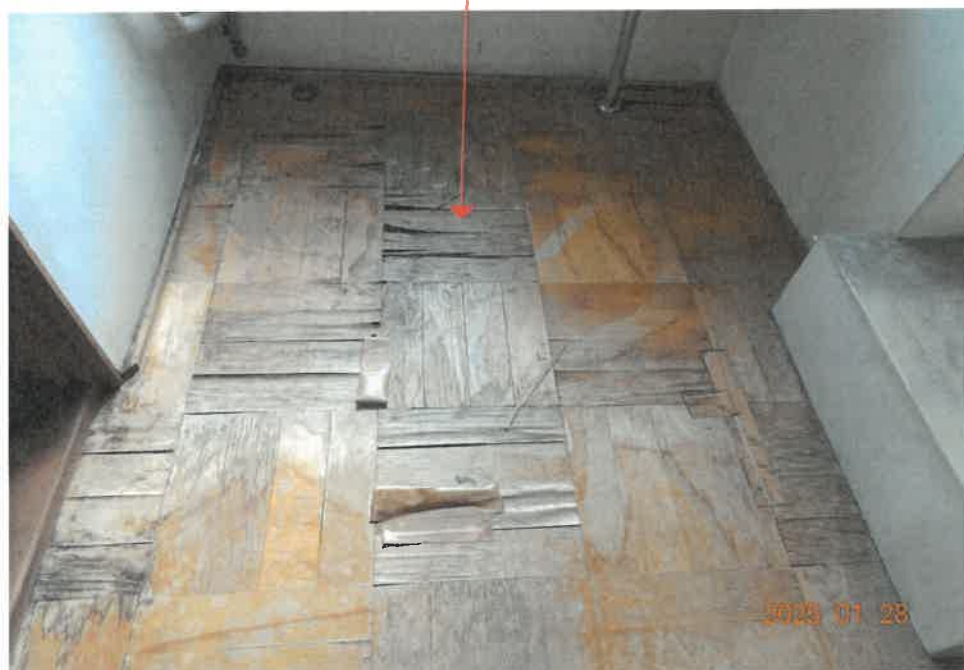
⑩ (202号室 床損傷箇所)
