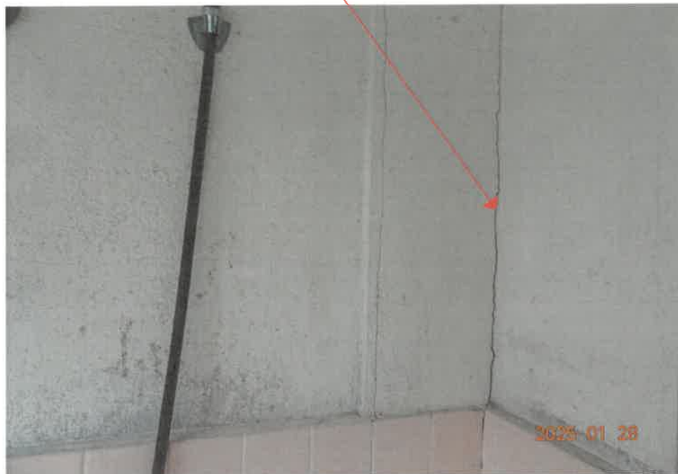
⑨ (202号室 浴室クラック)
