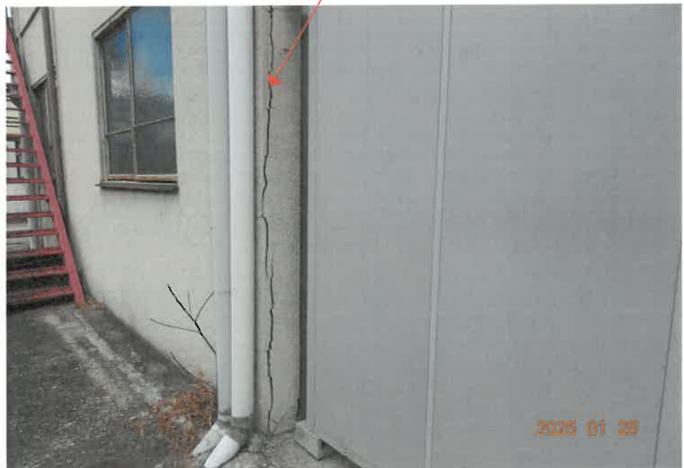
④ (外壁クラック)
