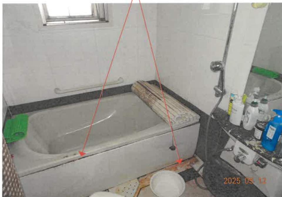
⑦ (カビが原因と考えられる汚損箇所)
