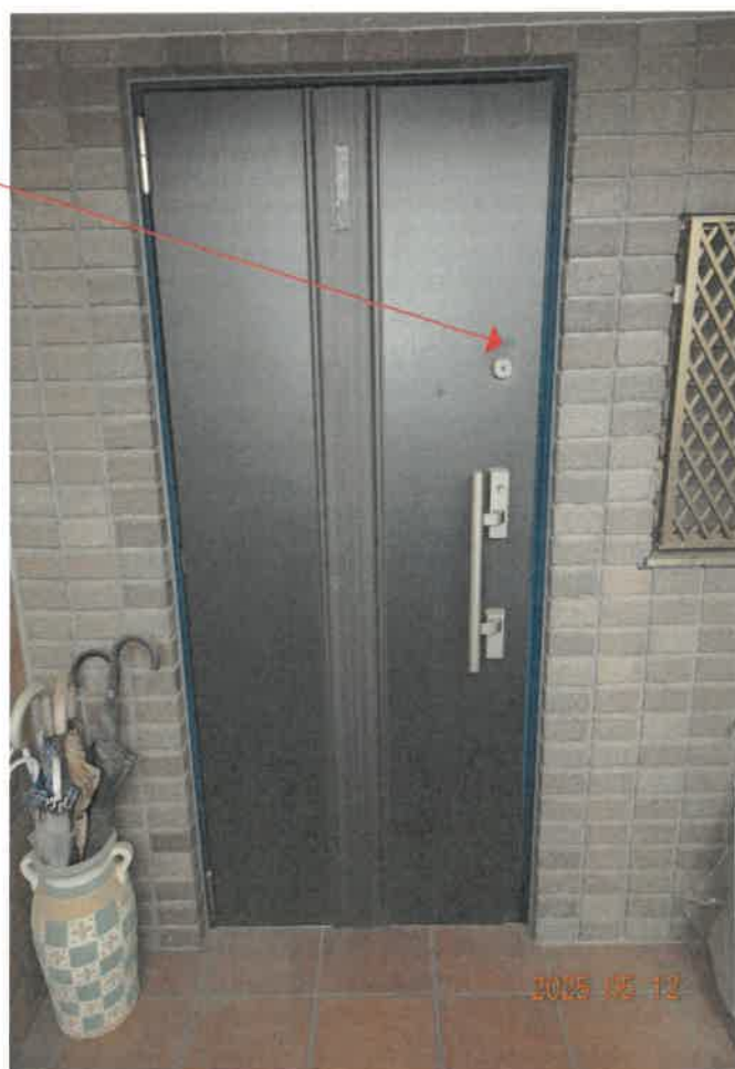
⑧ (玄関ドア へこみ箇所)
