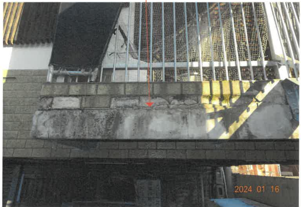
⑤ (物件 8 外壁損傷箇所)
