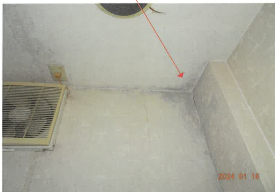
(物件9 店舗9 ②2 天井のシミ)
