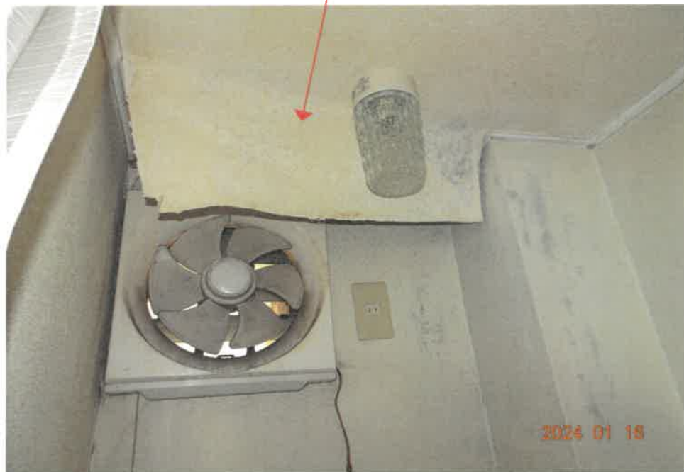
(物件9 店舗5 ②1 天井損傷箇所)
