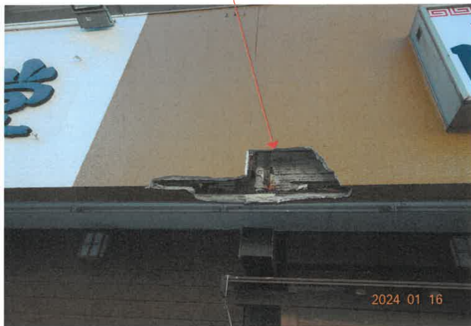
⑪ (物件9 外壁損傷箇所)
