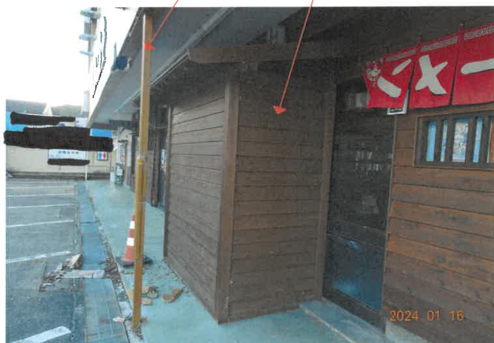
⑫ (物件9 木製の支柱、未登記増築部分)
