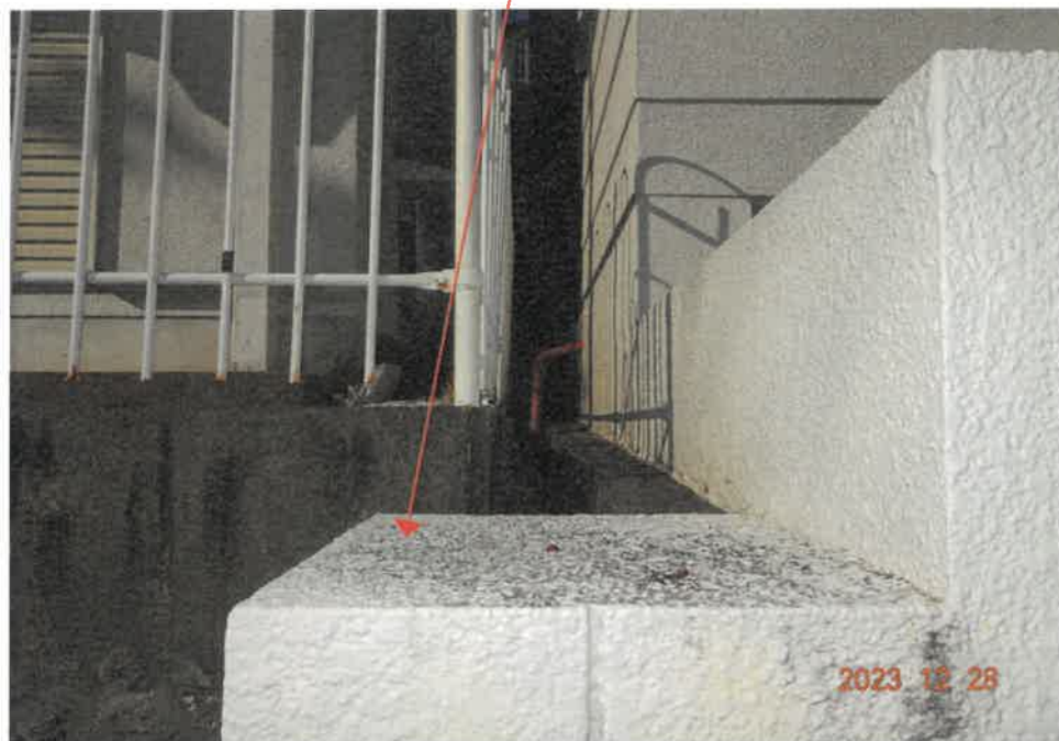
⑨ (南側隣接土地へ越境しているコンクリート塀)
