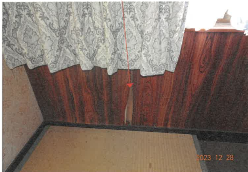
⑪ (1階南東側洋室 損傷箇所)
