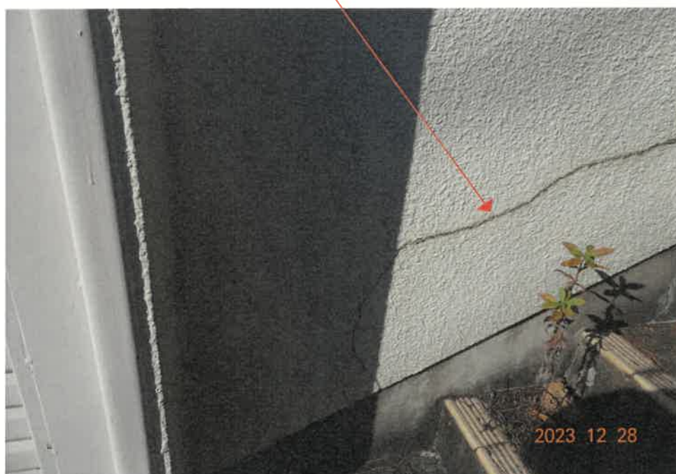
⑩ (コンクリート塀 クラック)
