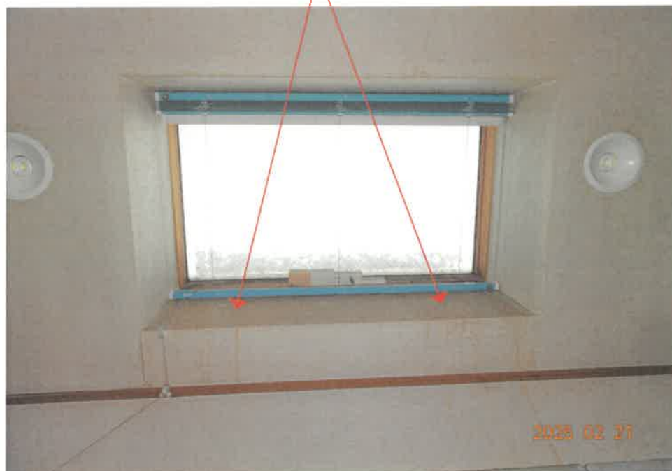
⑪ (物件4 キッチンの天窗周辺 雨漏り跡)
