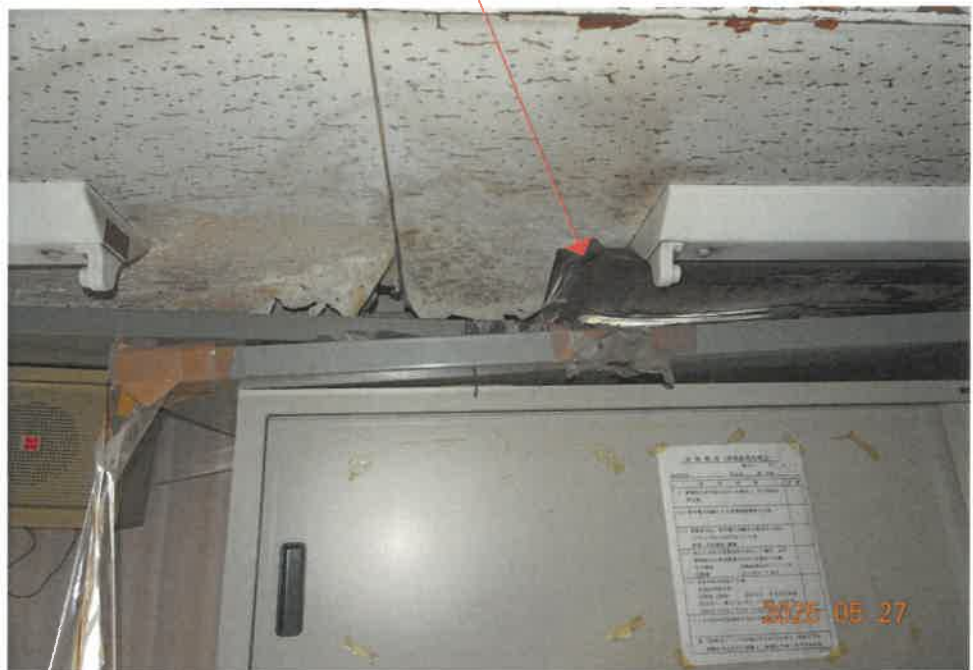
⑮ (2階南側中央倉庫 天井損傷箇所)
