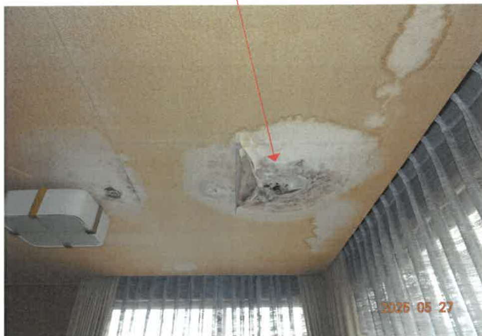
②⑦ (2階南東側洋室 天井損傷箇所)
