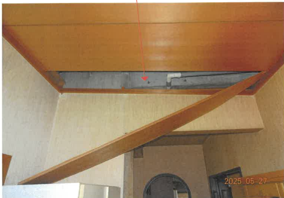
②① (1階縁側 天井損傷箇所)
