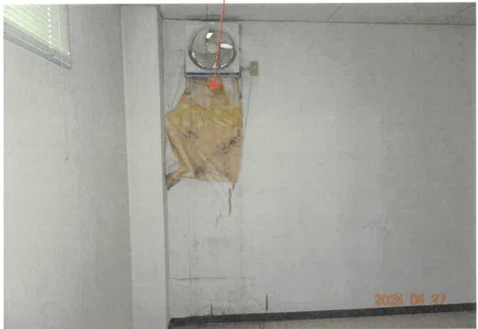
⑦ (2階南側倉庫 内壁損傷箇所)
