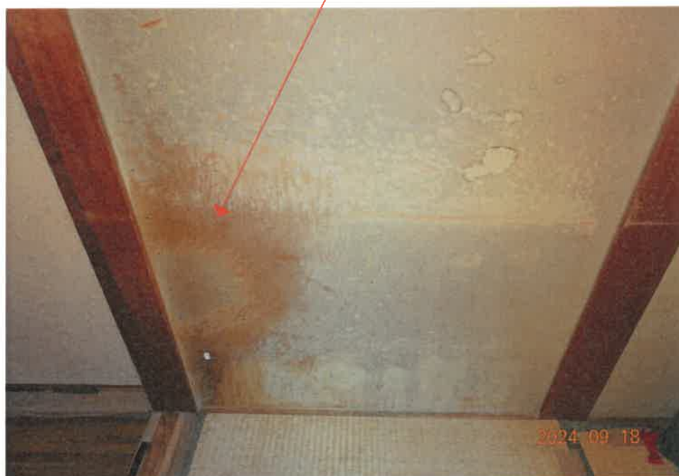
⑩ (2階南側和室 内壁汚損箇所)
