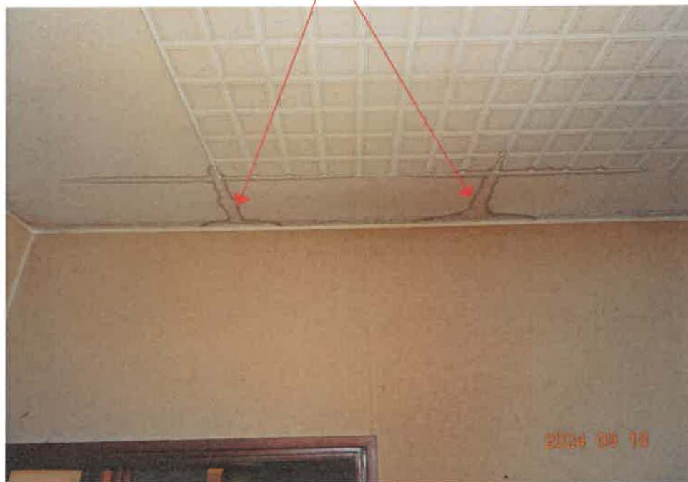
⑨ (DK天井 雨漏り跡)
