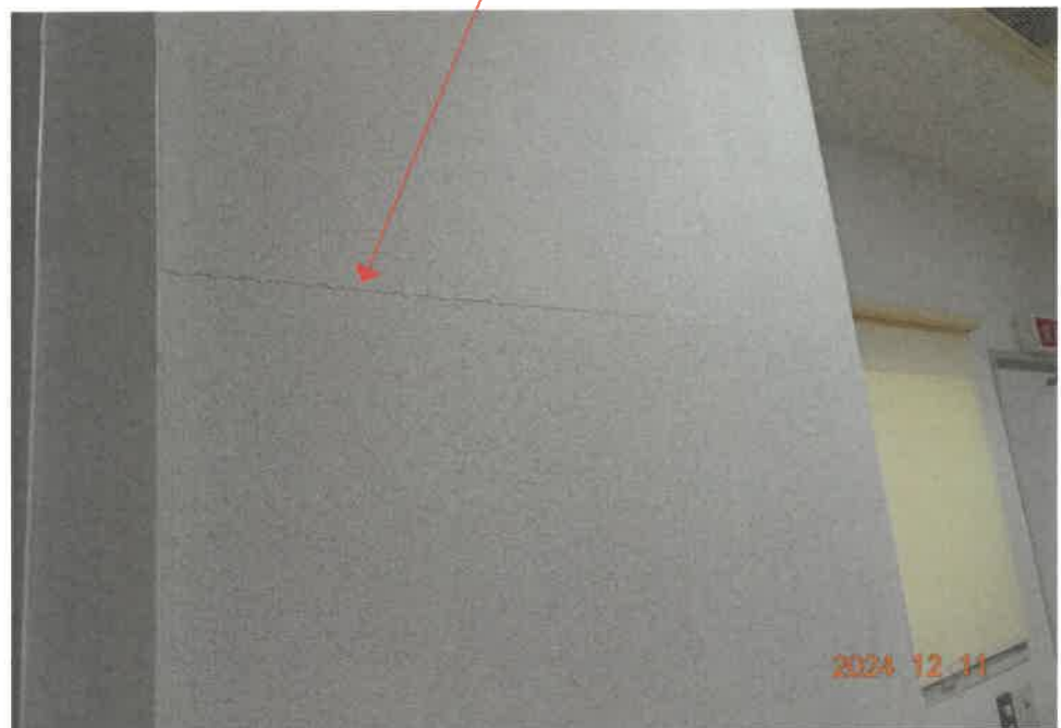
⑪ (1階廊下 内壁クラック)
