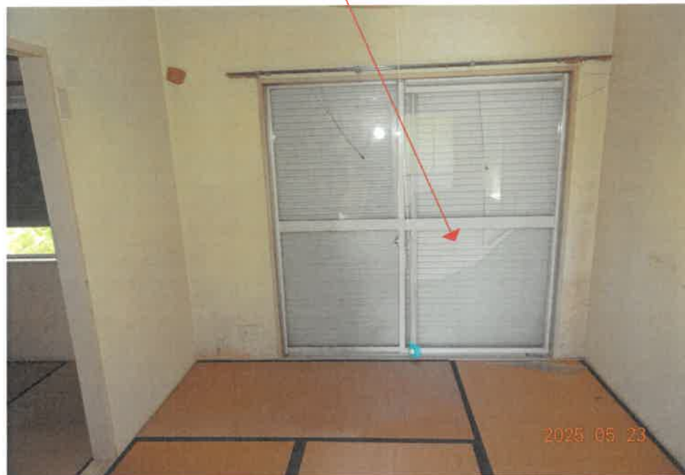
②⑤ (物件5 106号室 窓ガラス破損箇所)
