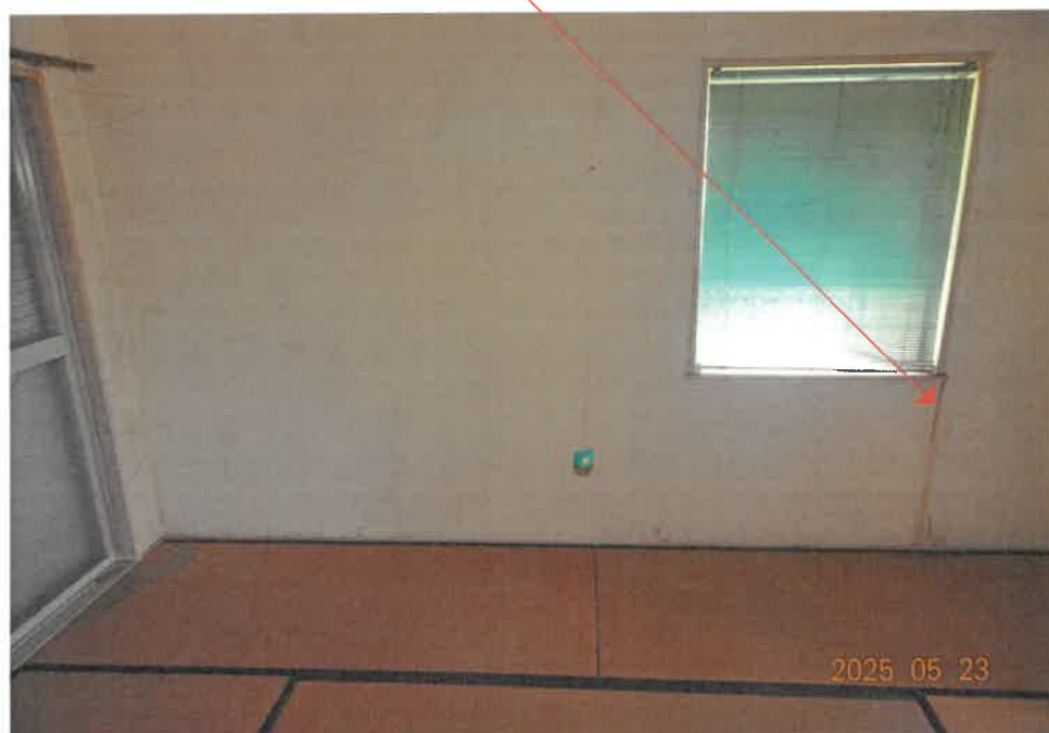
②⑥ (物件5 106号室 壁汚損箇所)
