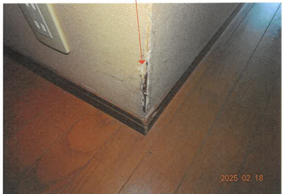
⑩ (2階廊下 内壁損傷箇所)
