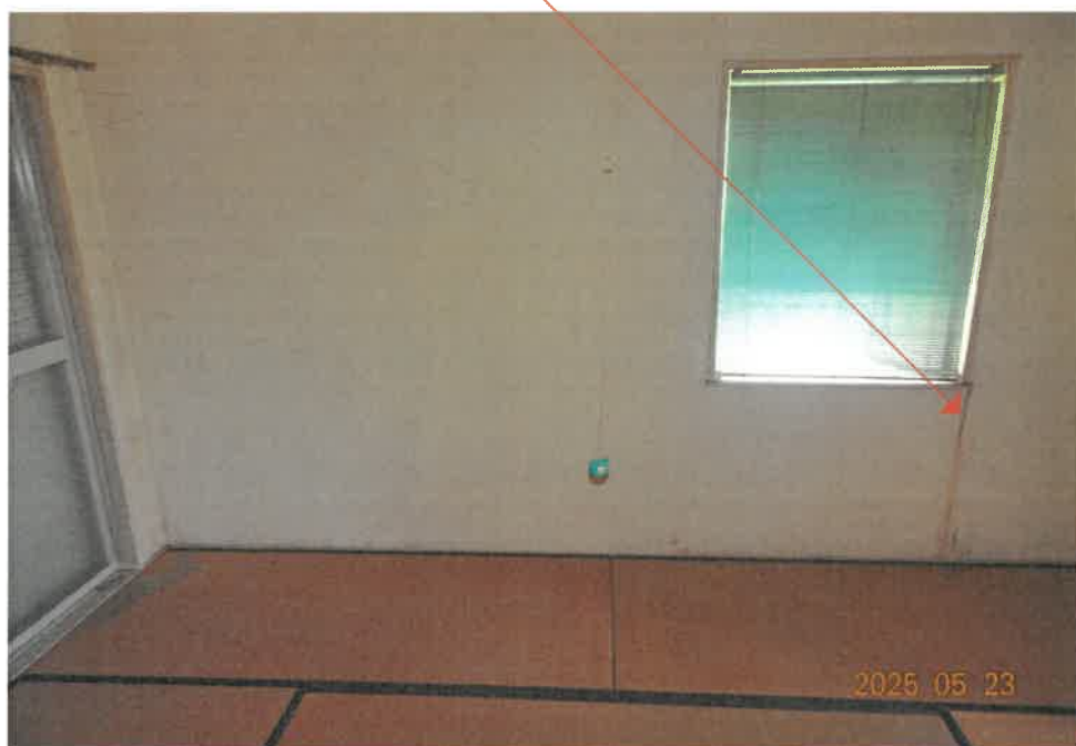
②⑥ (物件5 106号室 壁汚損箇所)
