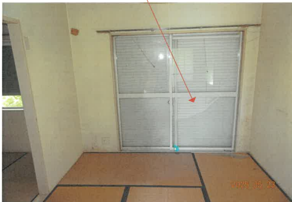
②⑤ (物件5 106号室 窓ガラス破損箇所)
