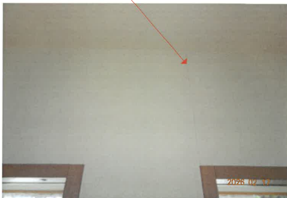
⑧ (2階ホール 壁クラック)
