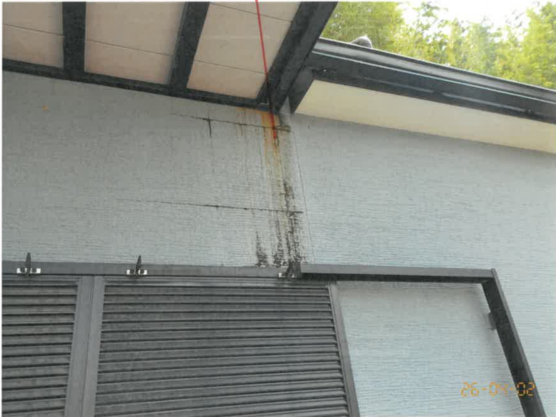
雨水が原因と思われる壁の汚れ
