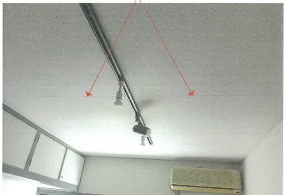
⑩ (2階中央洋室 天井クラック)
