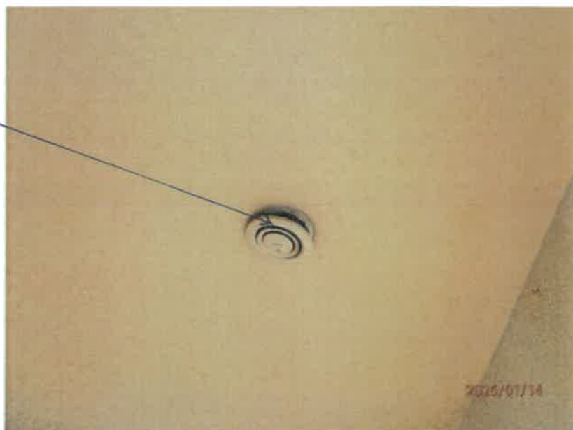
ナノイー発生機脱落
