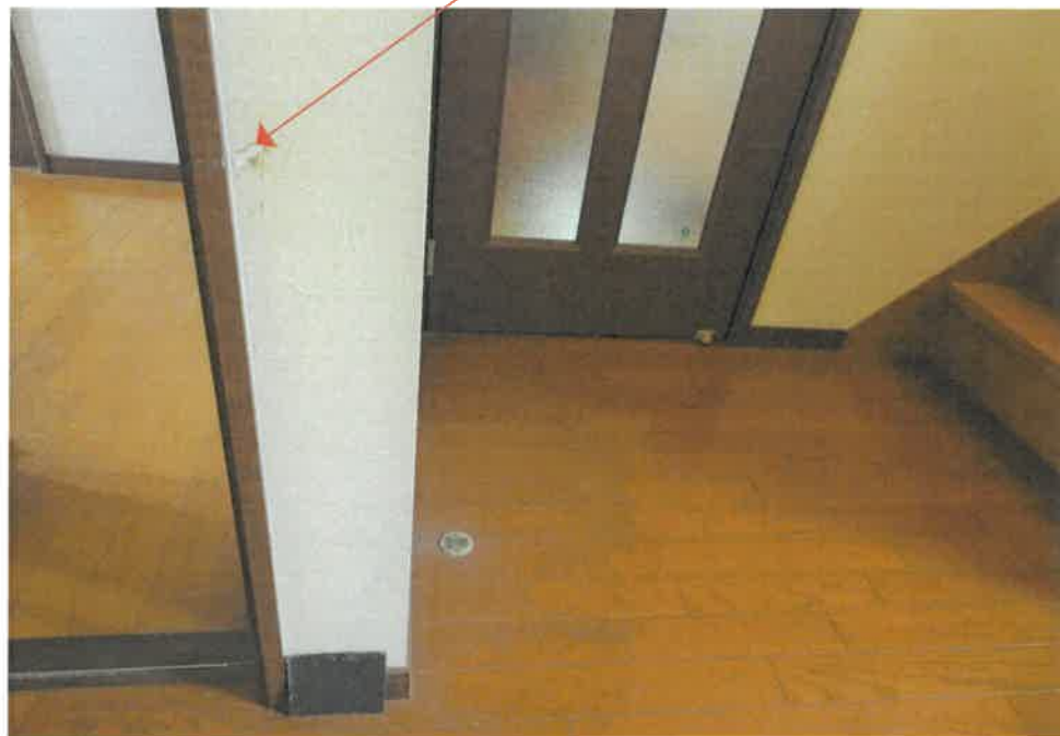
⑦ (1階リビングダイニング 壁クロス損傷箇所)
