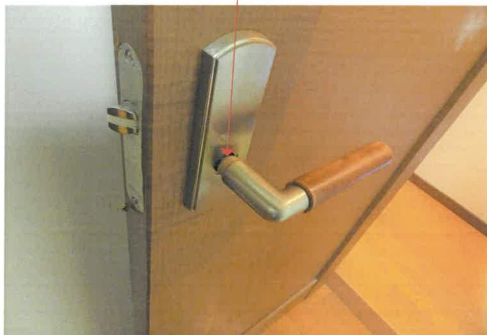
⑧ (2階西側洋室 ドアノブ損傷箇所)
