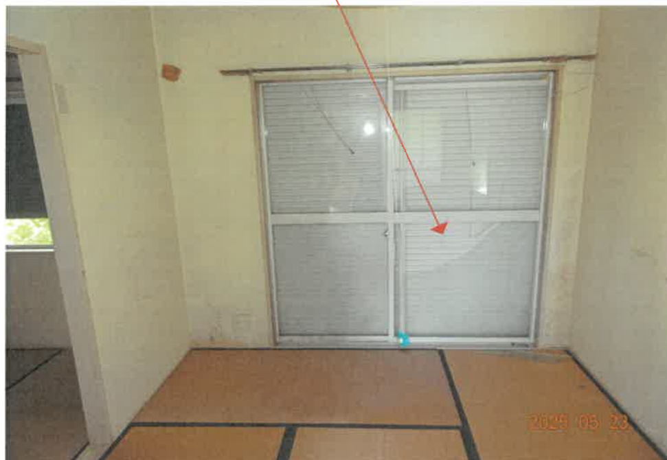
(物件5 106号室 ②5 窓ガラス破損箇所)
