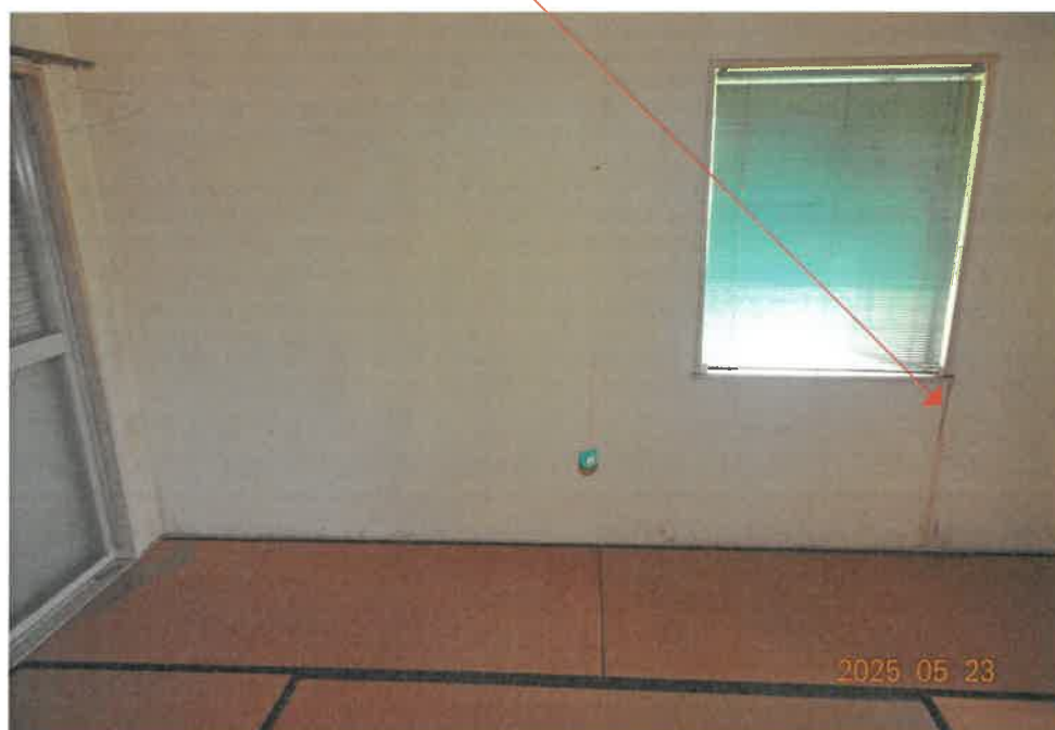
(物件5 106号室 ②6 壁汚損箇所)
