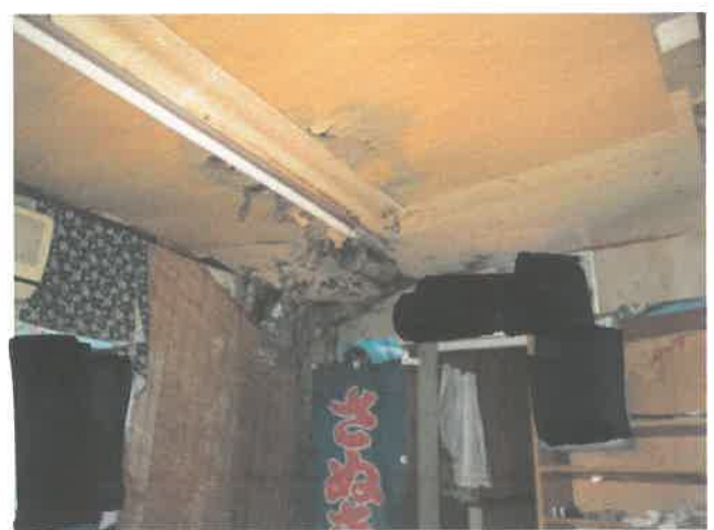
物件 6 未登記附属 天井付近
