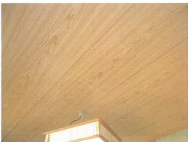
2階 和室天井付近(雨漏り跡)
