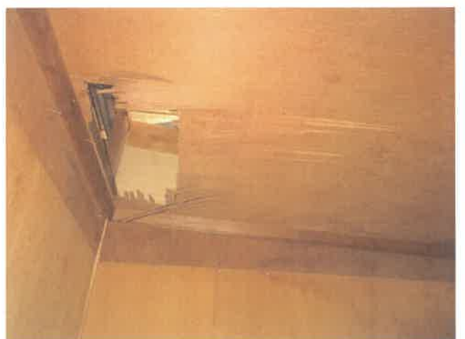
主建物 1階 板間先「入」天井付近
