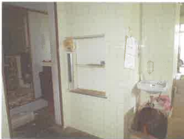
1階 厨房(ダクト)
