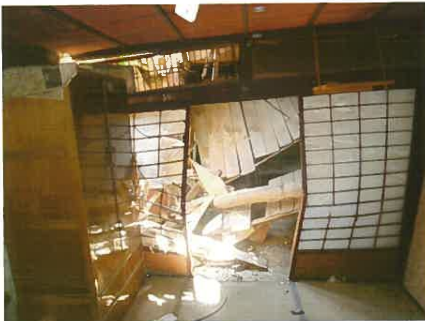
15 同上 天井が 崩れて いる状況
